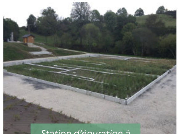
Station d'épuration à Saïgues
